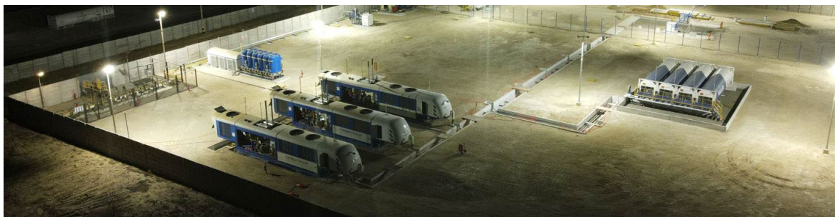
Estación de carga de GNL con cisternas
