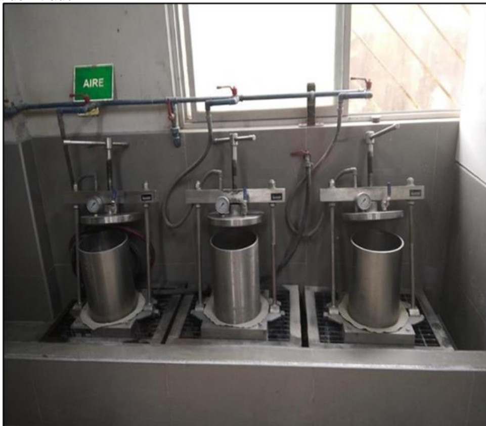
Sistema de filtrado
