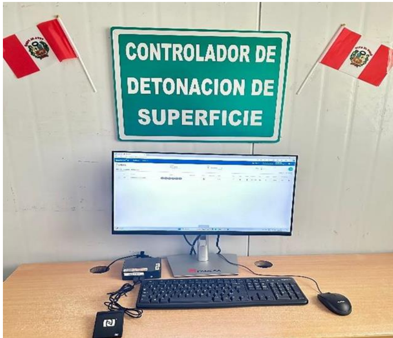
Anexo 9: Controlador de Detonación de Superficie SBC instalado en oficina mina
