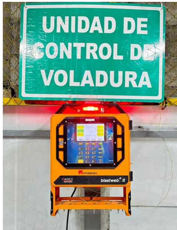
Anexo 8: Unidad de Control de Voladura BCU instalado en interior mina
