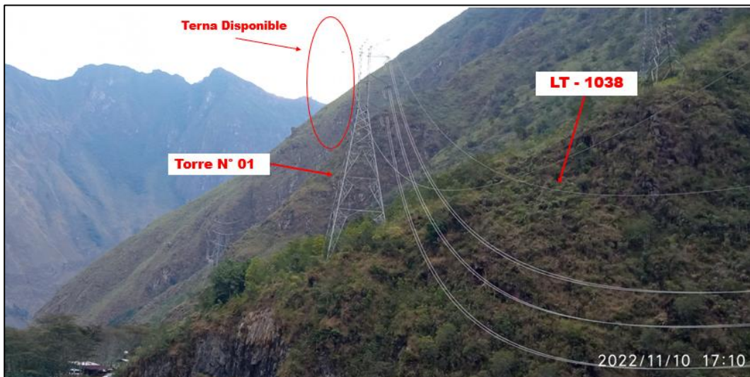
Vista de la línea de transmisión 1038
