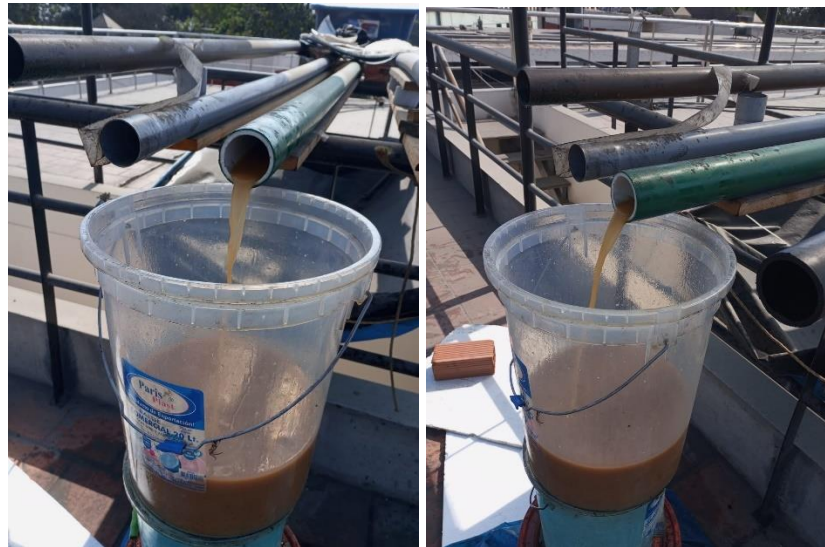
Flujo de agua residual graso vertiendo de la tubería de PPR
