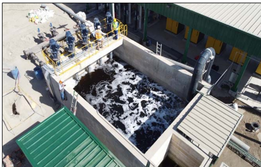
Arqueta de salida con desinfección de emergencia
