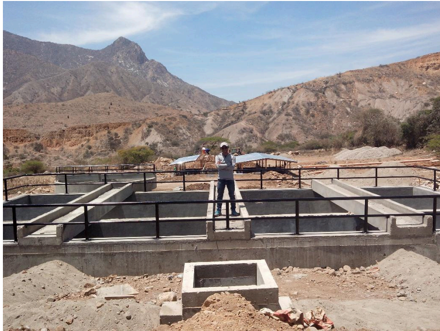
BARANDAS DE SEGURIDAD EN TANQUE IMHOFF
