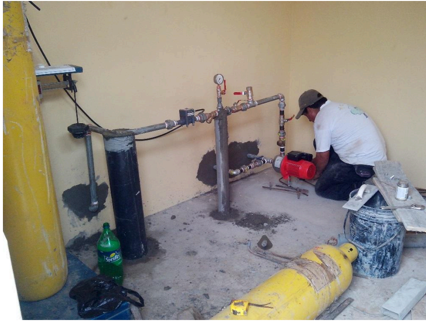
EQUIPAMIENTO DE CASETA DE CLORACIÓN EN PTAR
