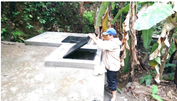
Captación La Peña Molino
