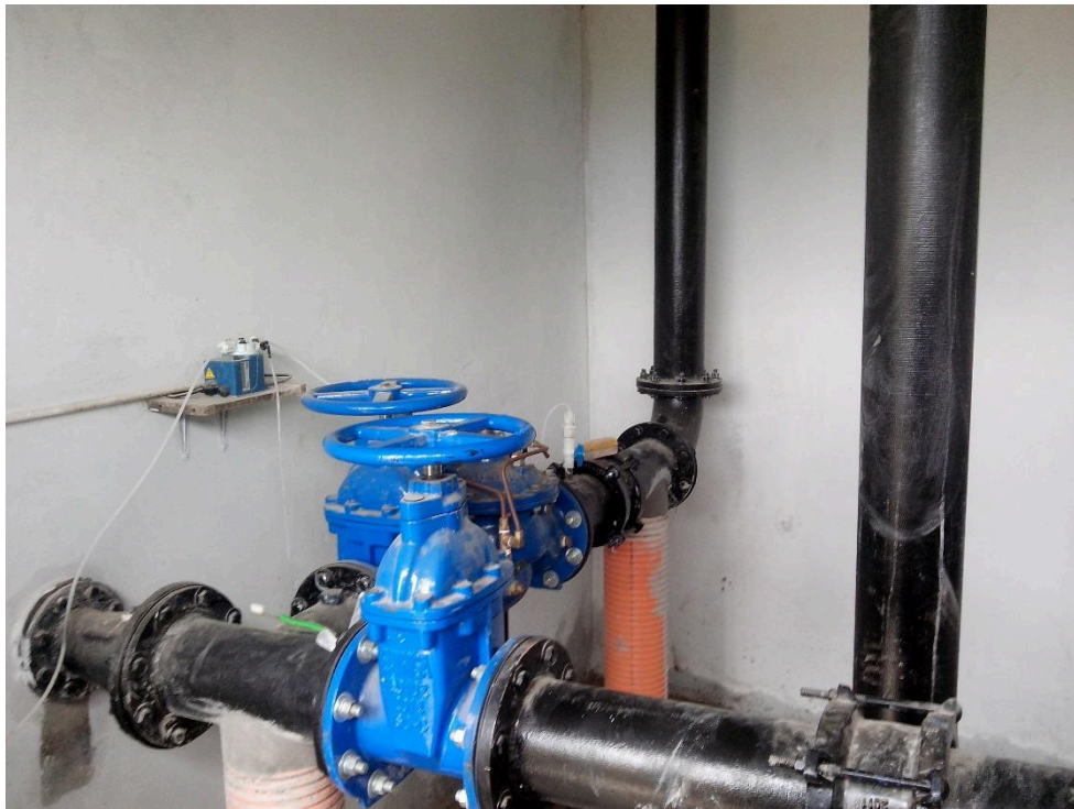
EQUIPAMIENTO DE CASETA DE RESERVOIRIO CIRCULAR
