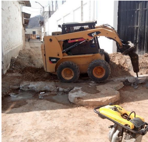
ROTURA DE PAVIMENTO
