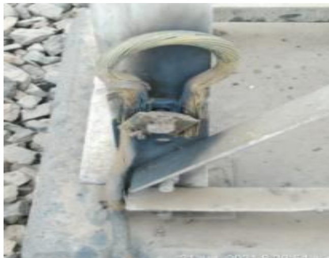
Figura 6. Huella de la descarga a tierra en la base de la estructura de los aisladores portabarras en 138 kV de la subestación Porvenir
