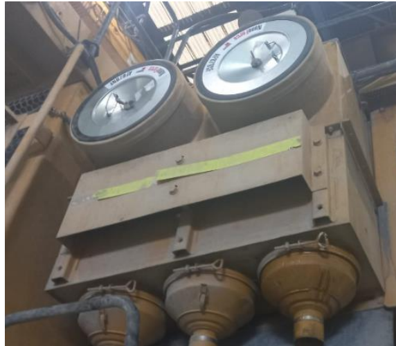
Figura 41 Filtros de aire del sistema de admisión
