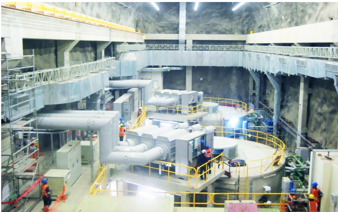
Figura 4.2: Casa de maquinarias de central hidroeléctrica El Platanal
