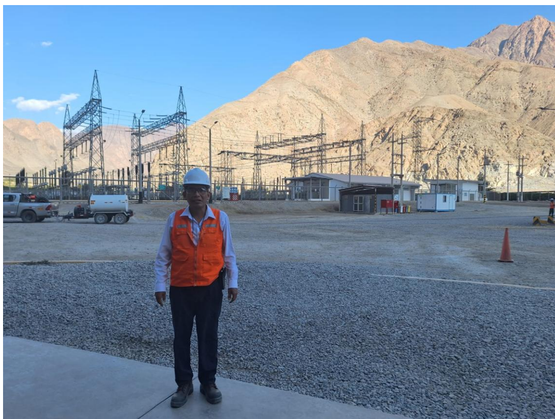
Figura 4.7: Patio de llaves de la central hidroeléctrica de El Platanal
